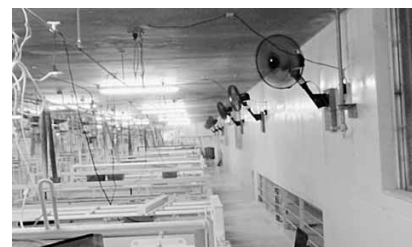
写真④ 壁かけ扇風機6台
